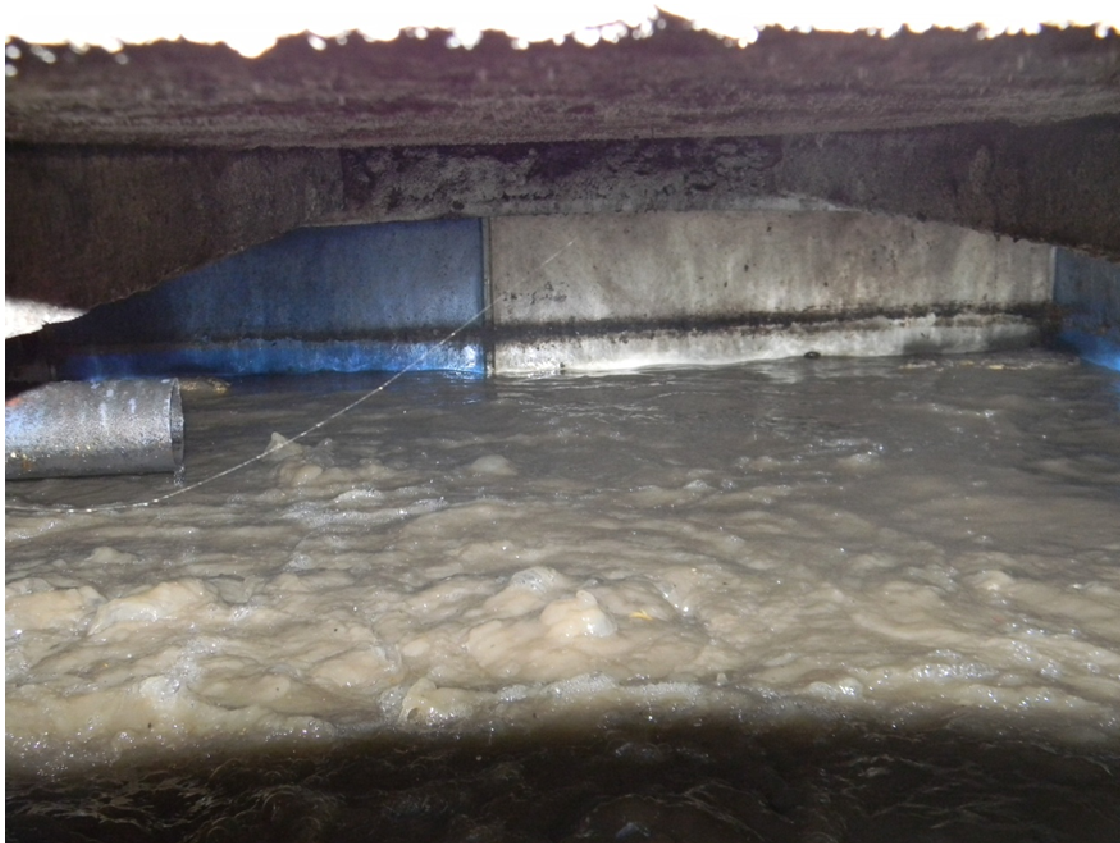
Obr. 23: Kalová nádrž DČOV
