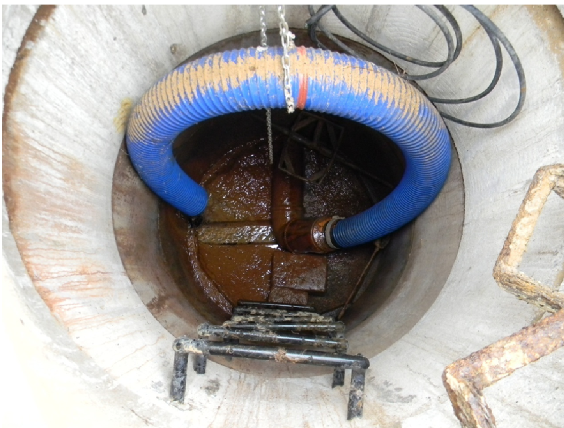
Obr. 15: KČOV Slavošovice, odtok přečištěné vody z rákosového pole, Foto: Jiří Vlach
